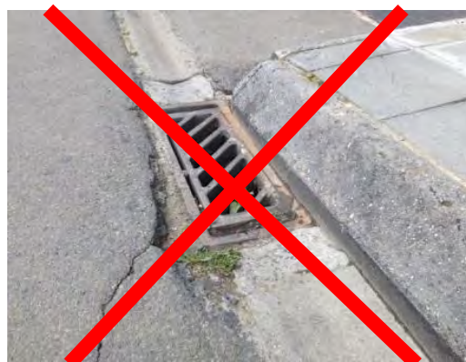
Avaloir dangereux Crédits photo : lejournalcatalan.com
