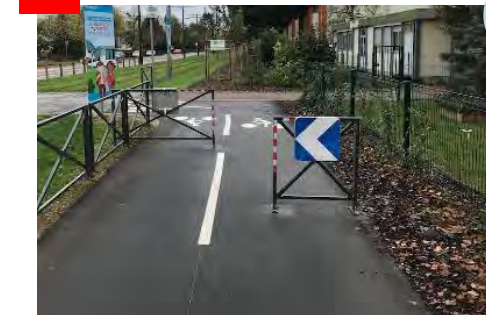
Barrières anti-intrusions dangereuses Crédits photo : robertsau.eu
