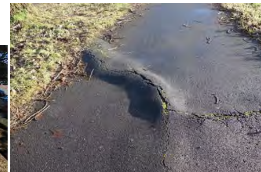
Racines d'arbres – inconfort voire chute.
