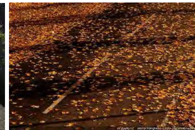
Feuilles sur aménagement – risque de chute
